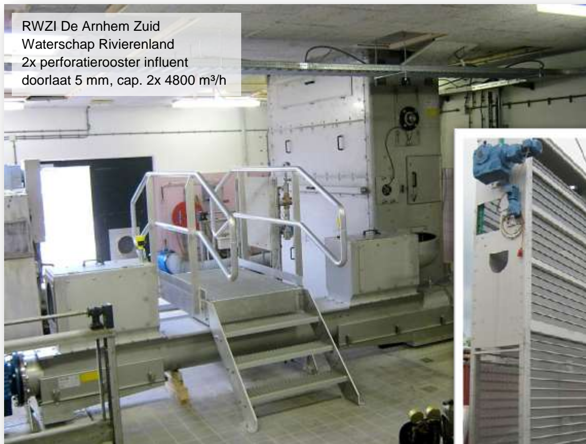
Foto boven: Installatie 1 e rooster en pers
